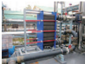
高温の万代源泉を入浴可能な温泉にし、温水を生み出す熱交換器。草津町発展の礎となった
